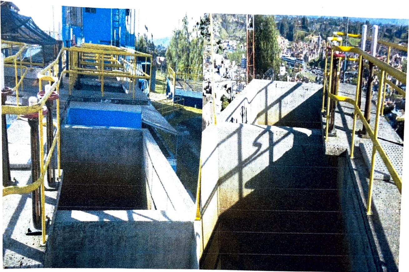
Ilustración 11. Filtros rápidos autolavantes
