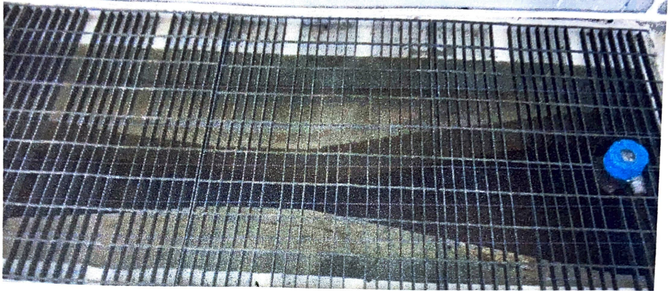
Ilustración 7. Canaleta Parshall instalada a la entrada de la planta de tratamiento de agua potable
